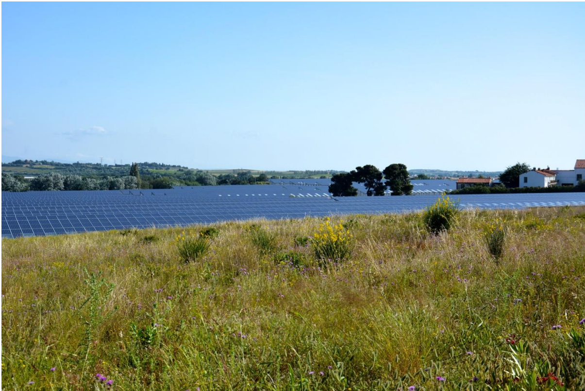
Photographie des serres photovoltaïques
